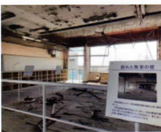
震災遺構請戸小学校
